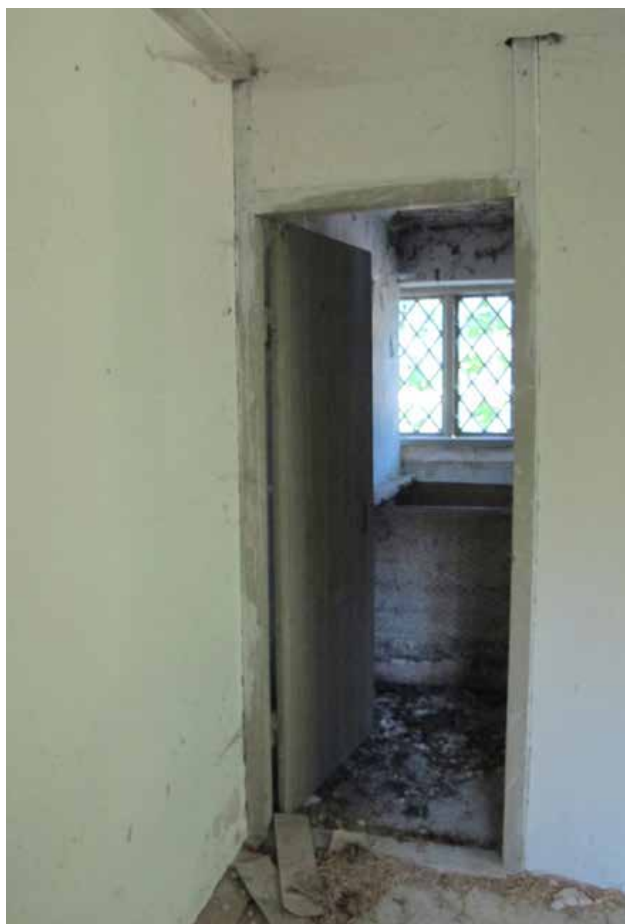
13. Interiør med revledør og nedbrudte gulve. MMN.
